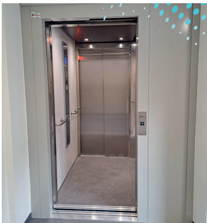
Ascenseur permettant la mise en accessibilité de l'ensemble des étages.
