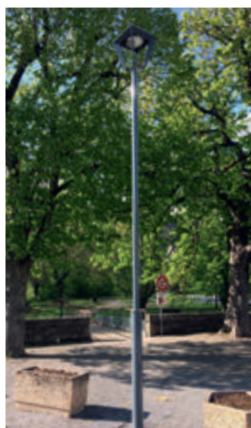
De nouveaux mats d'éclairage ont été installés, ainsi que des lampes plus économiques. L'extinction de l'éclairage public sur une partie de la nuit est effectif et devrait sur 2017 amener de substantielles économies sur les coûts de fonctionnement.
